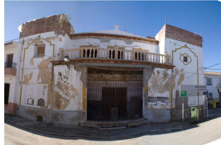
Ilustración 11. : Fachada del Cinema Palma. Actualmente en restauración
